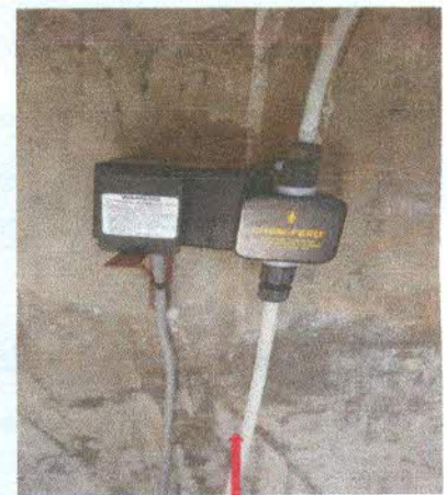
BOMBA CLORINADORA. POZO VICTOR RAUL
