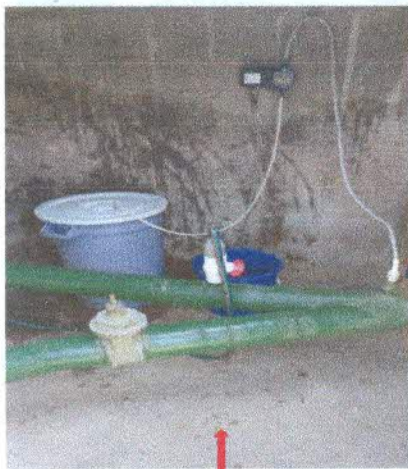
INYECCION DE CLORO
